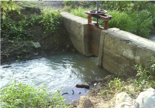
Compuerta del Canal San Pedro
